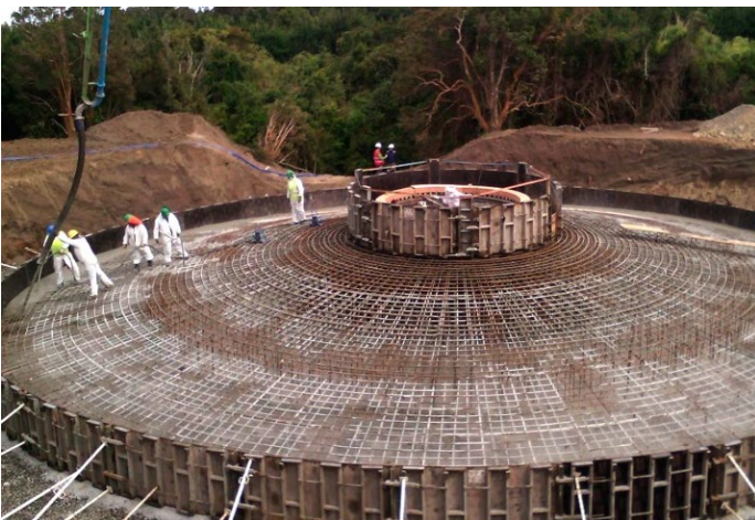
Foto 3 – Base torre eólica. (Foto: CJR Wind).
